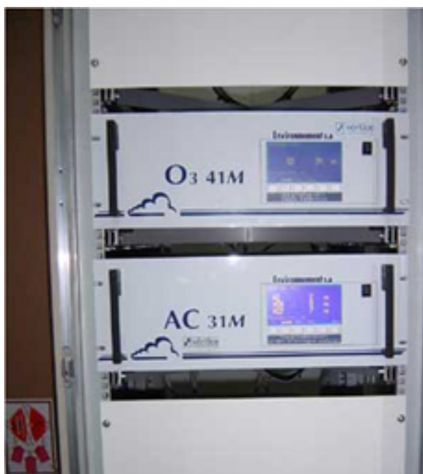
Analisadores de Ozono e de Dióxido de Enxofre da Estação de Monitorização da Qualidade do Ar de Coimbra/Instituto Geofísico
