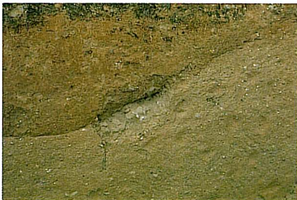
Fig. 33 - Deslocamento de argamassa de restauro no Castelo de Paderne.
