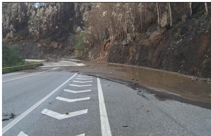
Imagem 29. Estrada da Beira, Coimbra - Áreas de instabilidade de vertentes Fonte: SIC Notícias
